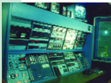
Consola de comandă și control
